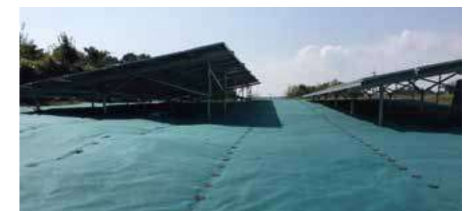
広島県発電所900kw
