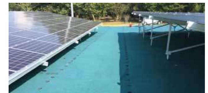
千葉県発電所500kw
