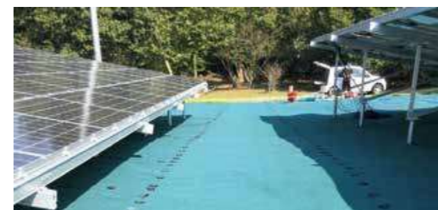
横浜発電所700kw
